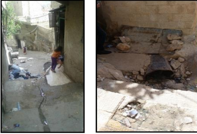
الصورتان (14- 15): تدمير أنابيب الصرف الصحي، وتراكم النفايات.
