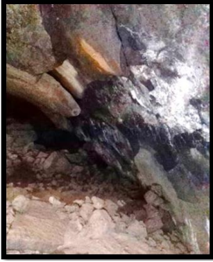
الصورة (38): انهيار قواعد البطانة الداخلية للجدار الأيمن.
