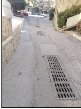
الصورة (22) شبكات تصريف مياه السيول، ساحة العين، بلدة منين.
