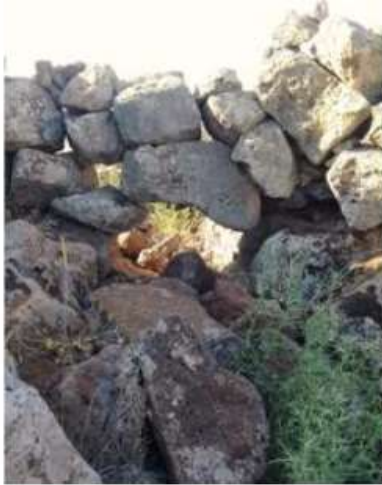
(الصورة 12) فتحة دخول الماء للقناة
