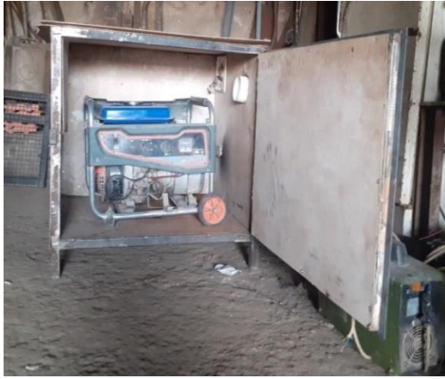
الشكل (9) المولد الكهربائي داخل الحاوية العازلة للصوت.
