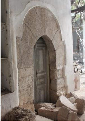
الصورة (14) البوابة السلجوقية في البيت 2/426 مؤذنة الشحم، المصدر: أرشيف الباحث، 2020.
